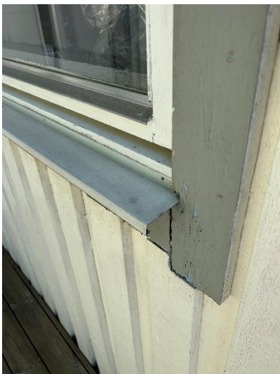
Uppvikta gavlar saknas på fönsterbleck.
