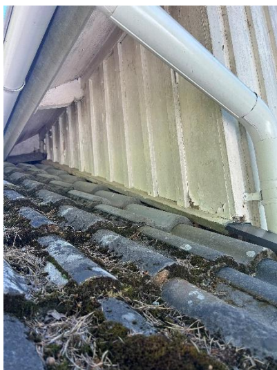
Plåt mellan tak och fasad saknas ovan tillbyggnaden.
