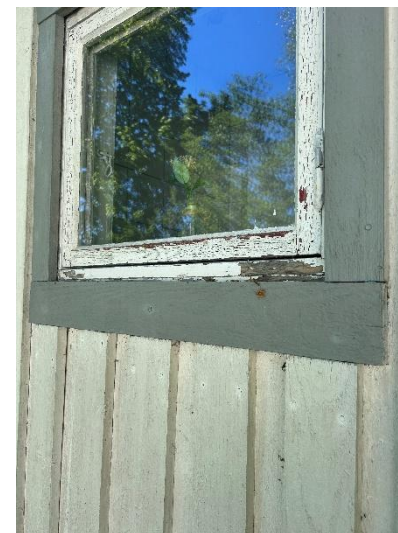
Underhåll/målning av fönster samt avsaknad av fönsterbleck.
