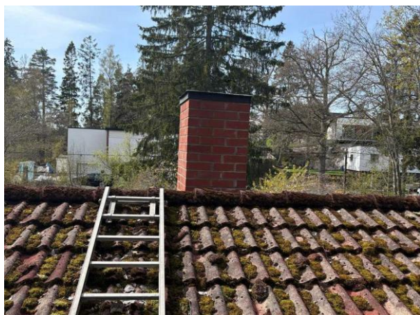
Bild 5: Utvändigt, Yttertak, Äldre tak Färgsläpp finns på vindskivor Mossa noterades på taket. Se riskanalys
