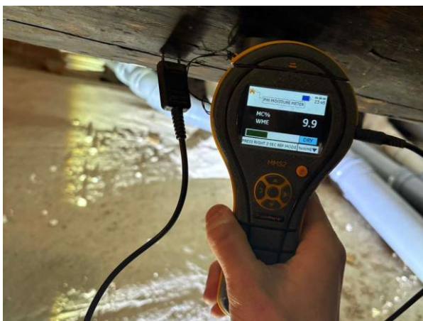
Bild 2: Utvändigt, Grund, Uteluftventilerad kryppgrund är en känd riskkonstruktion, se riskanalys.
