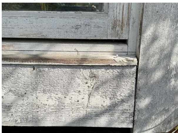
Bild 3: Utvändigt, Fönster, Uppvik på fönsterbleckens ändar saknas Färgsläpp finns på fönster Underbleck saknas till 2 fönster
