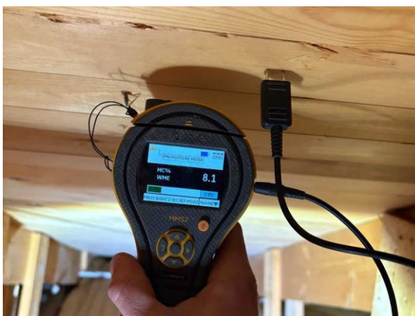
Bild 4: Utvändigt, Vind, Lokalt noterades det mikrobiell påväxt på underlagstaket. Se riskanalys. Inga förhöjda fuktvärden noterades
