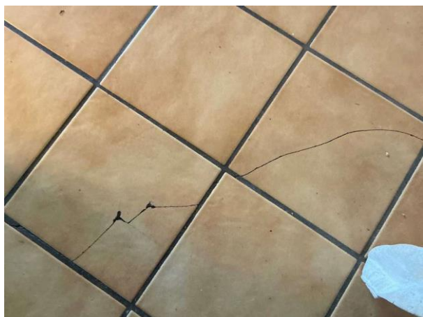
Bild 7: Invändigt, Entreplan, Hall, Sprickor noterades i klinkerplattor
