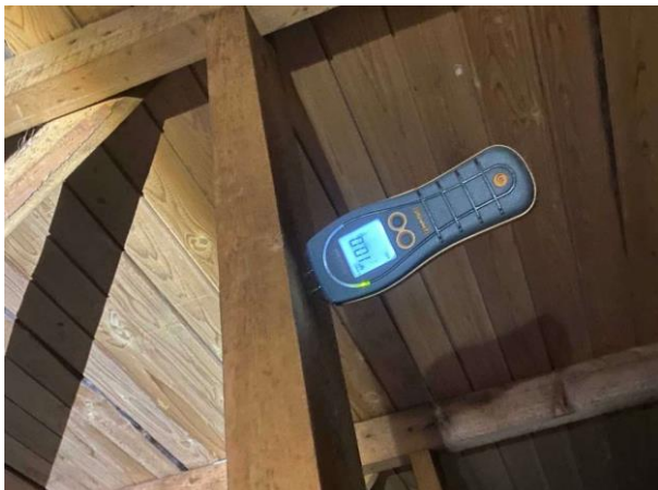
Bild 1: Utvändigt, Vind, Vinden är besiktad i anslutning till vindslucka (spång saknas) Huset är självdragsventilerat Lokalt noterades det Mikrobiell påväxt på under...
