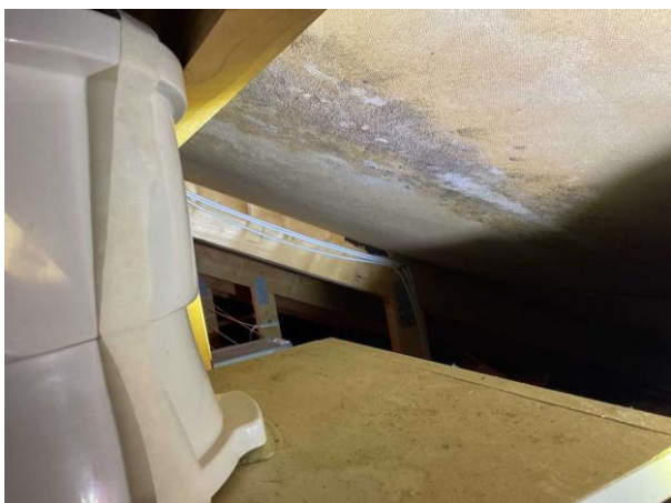
Bild 1: Utvändigt, Vind, Lokalt på vinden noterades det mikrobiell påväxt på underlagstaket Enklare underlagstak med boardskivor
