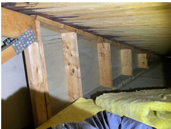
Bild 2: Utvändigt, Vind, Missfärgningar noteras på skivor vid gavlar
