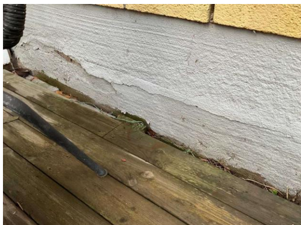
Bild 1: Utvändigt, Sockel, Sockeln är delvis dold av altaner Sprickor noteras på sockel
