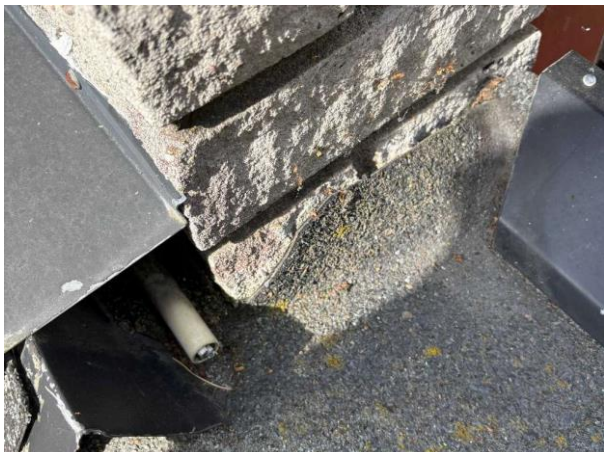
Bild 3: Utvändigt, Yttertak, Äldre tak Uppvik av papp saknas mot genomföringar Ståndplåt saknas på del av taket vid tillbyggnaden Se riskanalys
