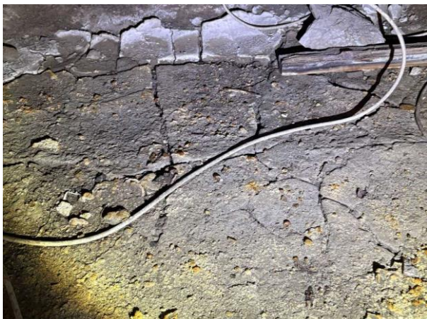
Bild 1: Utvändigt, Grund, Erge-bjälklag under originaldelen av huset, spår av inträngade fukt på marken
