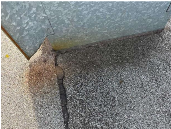
Bild 4: Utvändigt, Yttertak, Äldre tak Uppvik av papp saknas mot genomföringar Ståndplåt saknas på del av taket vid tillbyggnaden Se riskanalys
