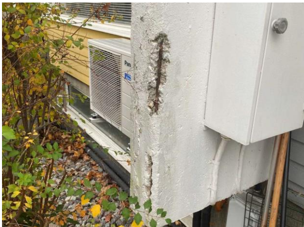
Bild 1: Utvändigt, Fasad, Färgsläpp finns på panelen samt torrsprickor i panelen Synlig armering noterades på betongdelen av fasaden mot grannen (på framsidan)
