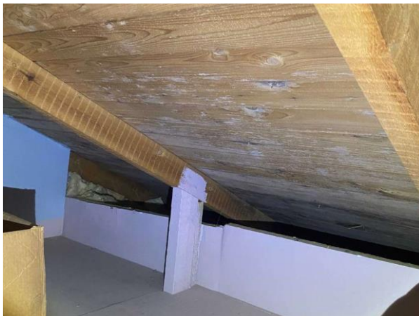
Bild 2: Utvändigt, Vind, Huset är självdragsventilerat, se riskanalysen Tätlist saknas runt vindsluckan Lokalt på vinden noterades det mikrobiell påväxt på underlags...
