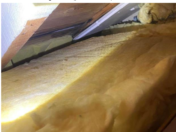
Bild 3: Utvändigt, Vind, Huset är självdragsventilerat, se riskanalysen Tätlist saknas runt vindsluckan Lokalt på vinden noterades det mikrobiell påväxt på underlags...
