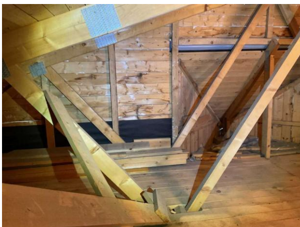
Bild 2: Utvändigt, Vind, på vinden noterades det mikrobiell påväxt och fuktrosor på underlagstaket
