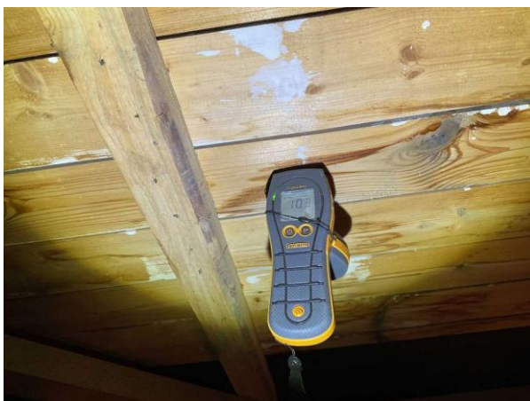
Bild 8: Utvändigt, Vind, Lokalt på vinden noterades det mikrobiell påväxt och fuktrosor på underlagstaket se bilaga 4
